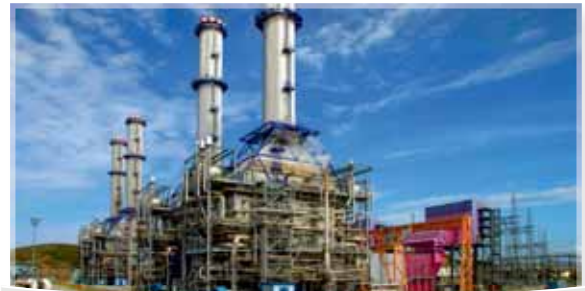
YENI ELEKTRİK 865MW CCPP-TURKEY
