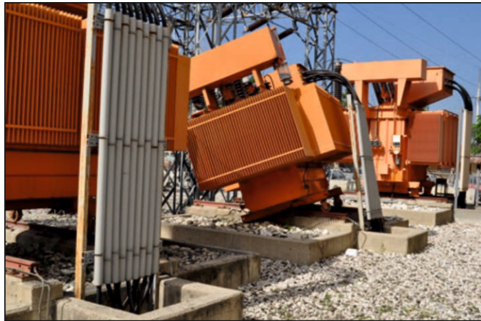
Şekil 2.1b Elektrik Trafolarında Oluşan Deprem Hasarı (Federal Emergency Management Agency internet sitesi'nden alıntıdır, www.fema.gov )
