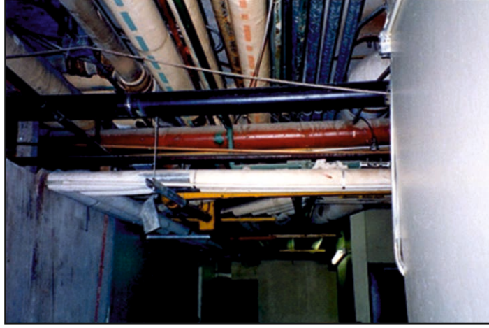
Şekil 2.1a Elektrik Borularında Oluşan Deprem Hasarı (Federal Emergency Management Agency internet sitesi'nden alıntıdır, www.fema.gov )
